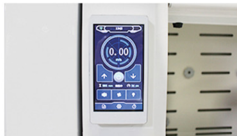
Fume hood controller
